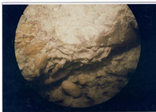
FOTO 4 Stratigrafia S2 (cfr. fig. 3) Nella foto è mostrata la superficie di separazione tra massetto (parte alta della foto) e caldana (parte bassa della foto). Risulta evidente il diverso grado di compattezza e coesione dei due elementi.
