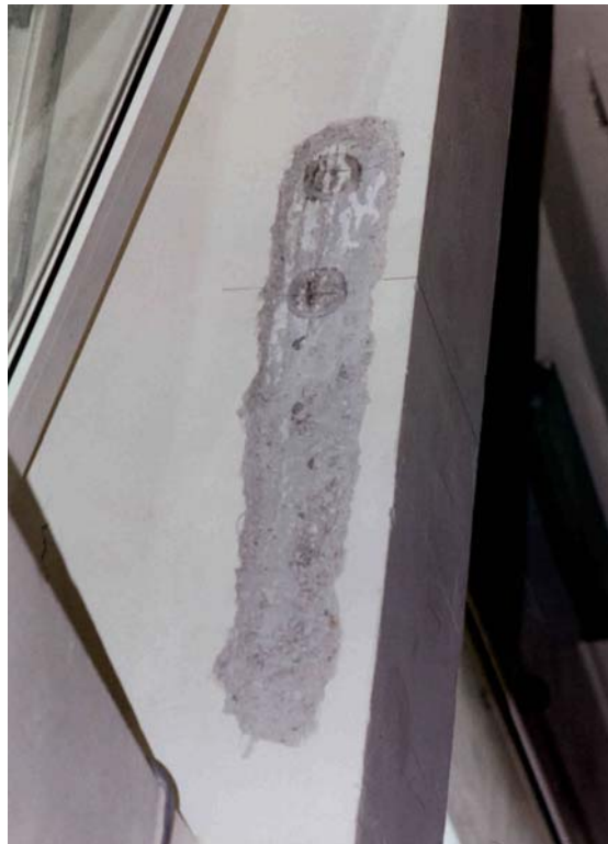
Figura 6.1.2.12 – Pilastro su cui è stata eseguita una indagine ultrasonica (Foto fornita dall'ing. Maurizio Scansani)
