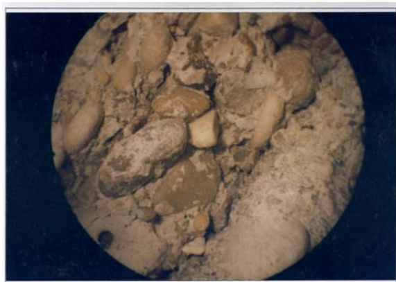
FOTO 3 Stratigrafia S2 (cfr. fig. 3) Nella foto è mostrata la caldana presente nel solaio. Gli inerti risultano di medie dimensioni e poco legati dalla malta cementizia.
